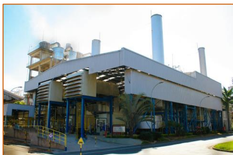
Corn Mogi (Ingredion) 34.9 MW + Vapor: 162 t/h Gás Natural
