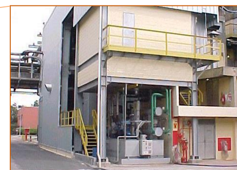
Capuava (Braskem) 17.0 MW Vapor de processo
