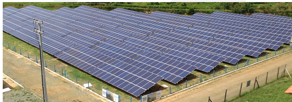
Usina solar fotovoltaica: Fernando de Noronha (PE).
